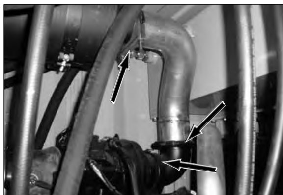
Sistemas de exaustão
