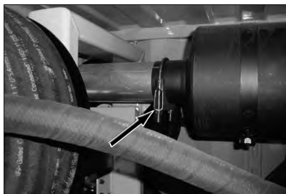
Sistemas de exaustão
